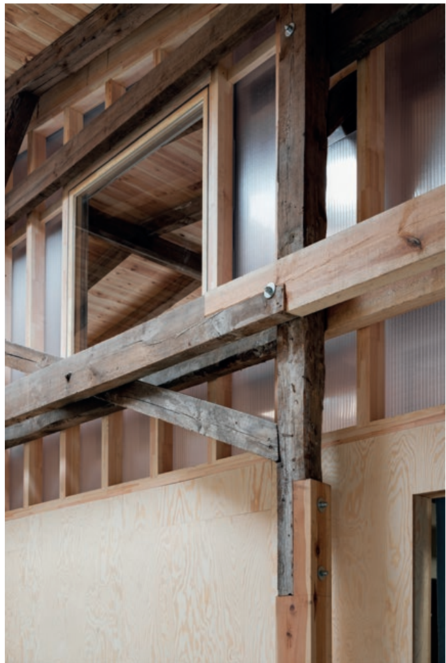
Abb. 21: Beim Umbau der Scheune von 05_Hof Prädikow wurden Bauteile und Materialien sorgsam recycelt, zwischengelagert und im Sinne eines zirkulären Bauens wiederverwendet © Studio Bowie
